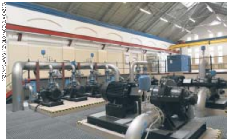
Stacja Uzdatniania Wody przy ul. Żeglarskiej
